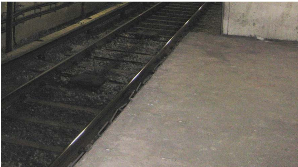
Inböjda armeringsjärn sticker ut från plattformen
