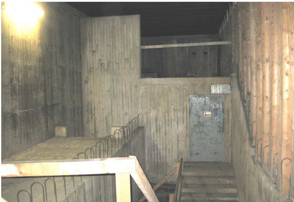
Hisschakt och dörr till maskinrum
