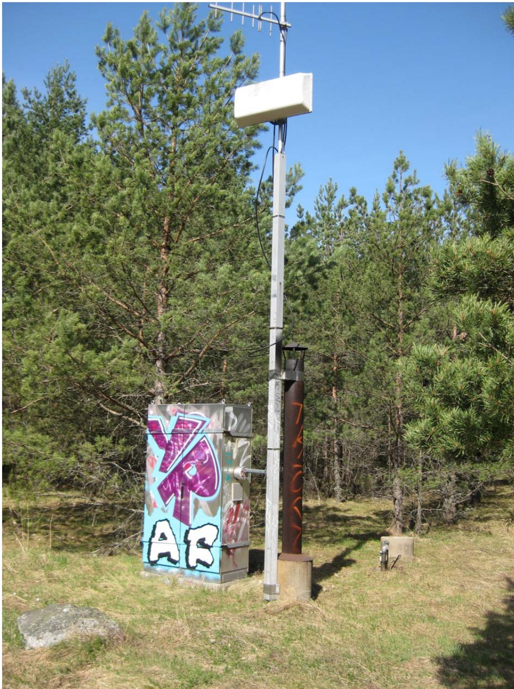
Skorsten och bränslepåfyllnadsrör till reservkraften.
